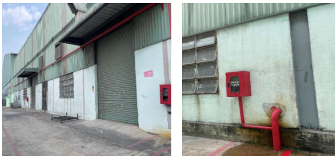
Hình 4.19. Hệ thống PCCC của Dự án
